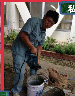
ひび割れた花壇
