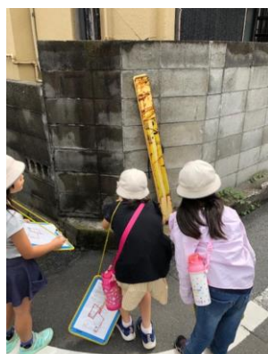
曲がった棒とヒビ割れた塀
